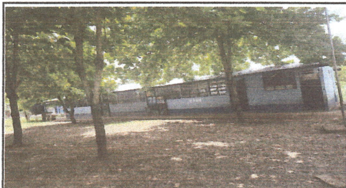
FOTOGRAFIA 5: PINTURA EN MAL ESTADO
