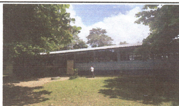
FOTOGRAFIA 6: PINTURA EN MAL ESTADO
