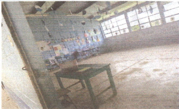
FOTOGRAFIA 1: PISO EN MAL ESTADO (CAMBIO DE PISO A CERAMICO)
