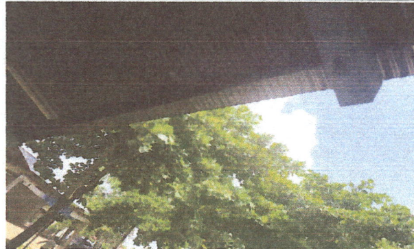
FOTOGRAFIA 2: FALTA DE CANALES
